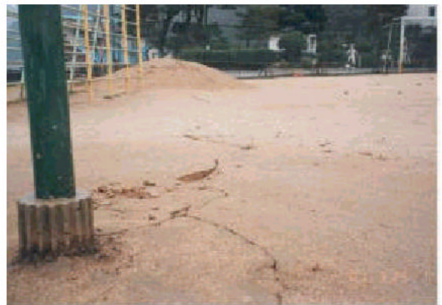
広島県河内町 河内小学校グランドの地割れ
