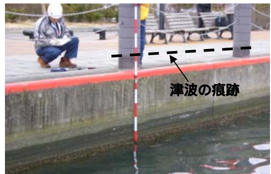
柱に変色した痕が見られる
