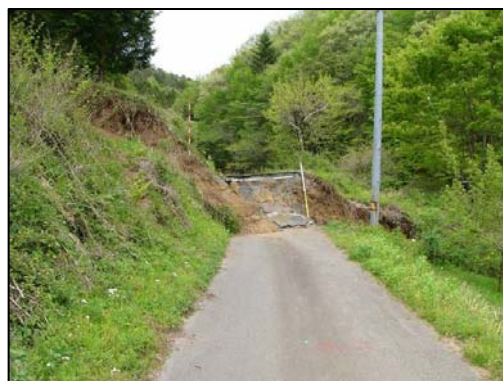
写真 1 道路を横切って露出した断層 (図 3-25①から撮影) 走向は北西-南東方向。南西側がほぼ 垂直に約 1.8m 沈下している。
