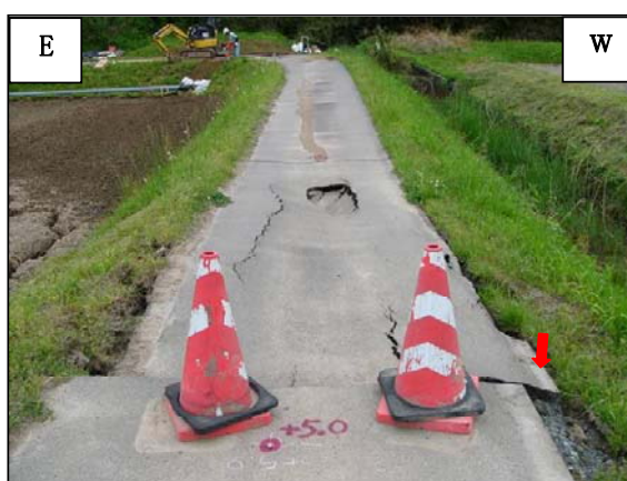
写真 9 道路に亀裂が生じ、西側へずれがみられる （図 3-26⑧から撮影）
