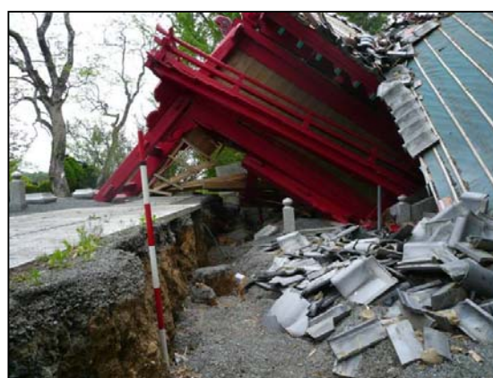
写真 7 瓦解した山門と山門直下の断層 （図 3-26⑥から撮影）
