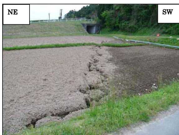
写真 8 亀裂が南東方向に伸び、南西側に沈降 （図 3-26⑦から撮影）
